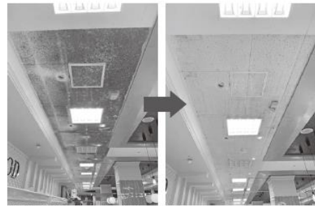
カビが生えて黒くなっていった天井が、1度の施工で白く清潔に。目視できないバクテリアやウイルスにも効果を発揮
