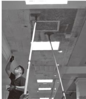
除カビ・殺カビ・防カビの3ステップで処理。黒かな箇所はハケを使って丁寧に塗りこむ。カビが作用して発生する悪臭の予防効果も期待できる
